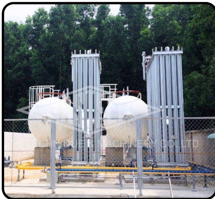
30 TON TANK - LPG VAPORIZER 500KG/HR
